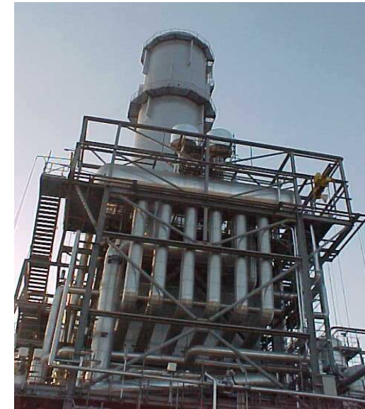
Caldera de recuperación
