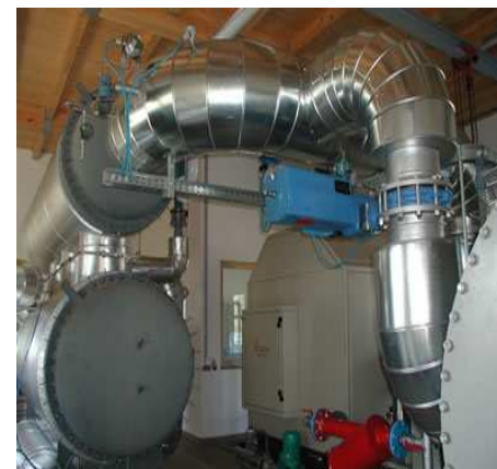
Instalación similar de Ciclo Ormat en una cementera alemana
